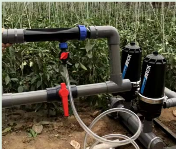
Fot. 2. Zwężka Venturiego z bypassem i filtrami
